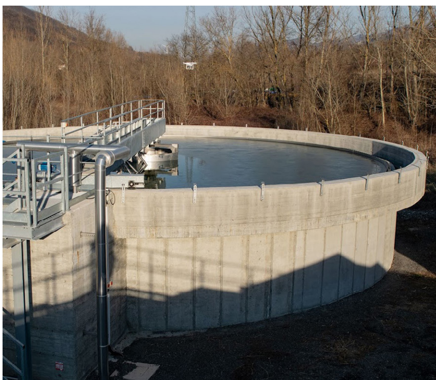
Il depuratore di Borgo Val di Tarò
